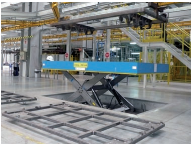
Scherenhubtisch in einer Automobiltaktstraße
